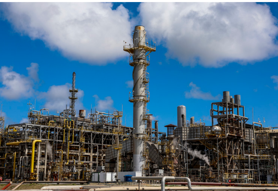
Unidade de hidrotreatamento de geração de hidrogênio da Refinaria Abreu e Lima, da Petrobras, em Ipojuca (PE). Hidrogênio de baixa emissão de carbono está entre as sete áreas do plano estratégico da Aneel.
