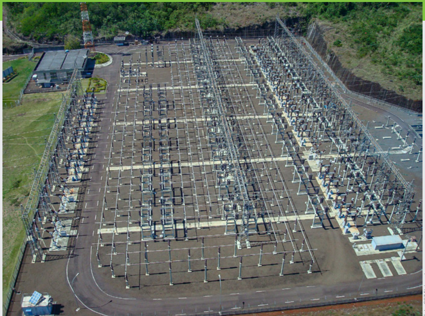
Segundo a Eletrobras, a subestação de Salto Osório (PR) receberá ampliações e melhorias neste ano.
