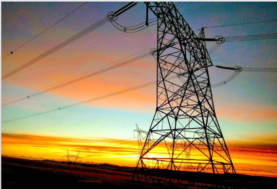
Até 2027, a Eletrobras anunciou investimentos de R$ 6,7 bilhões para a construção de sete novas subestações e 19 novas linhas de transmissão.
